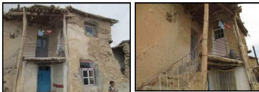
شکل ۸. مسکن تخریبی در روستای قلعه رستم در شهرستان ازنا
