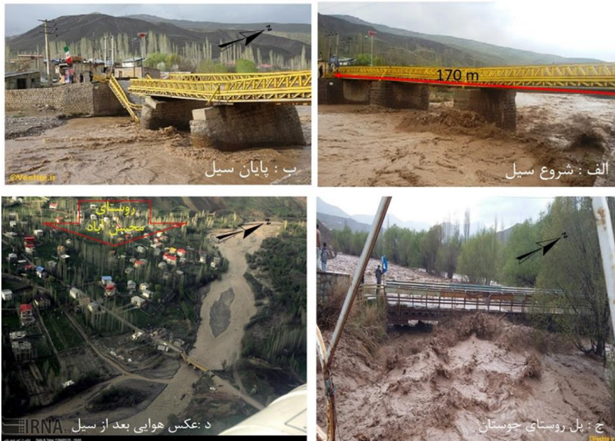
عکس ۳ تخریب پل‌های روستای (الف، ب، ج، پل وشته)، (ج، پل جوستان) در نتیجه تغییر سطح اساس شاهرود بعد از احداث سد در سیل فروردین ۱۳۹۴
